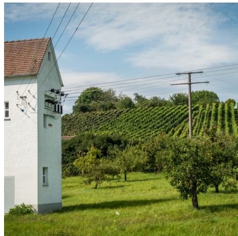
Transformateurs SiC dans le réseau électrique
