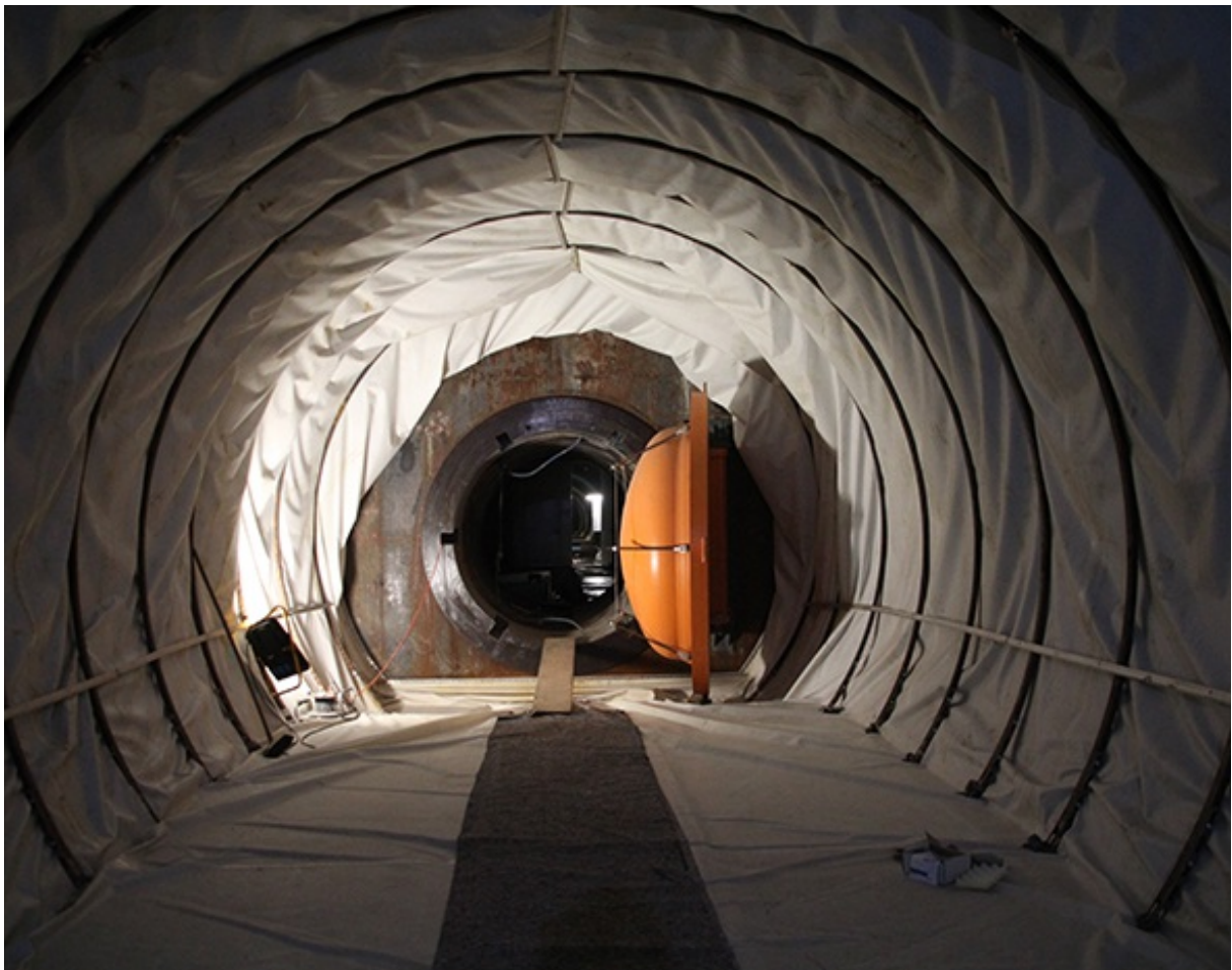
L'intérieur d'un réservoir d'air comprimé, au cœur de la montagne. Source : ALACAES
