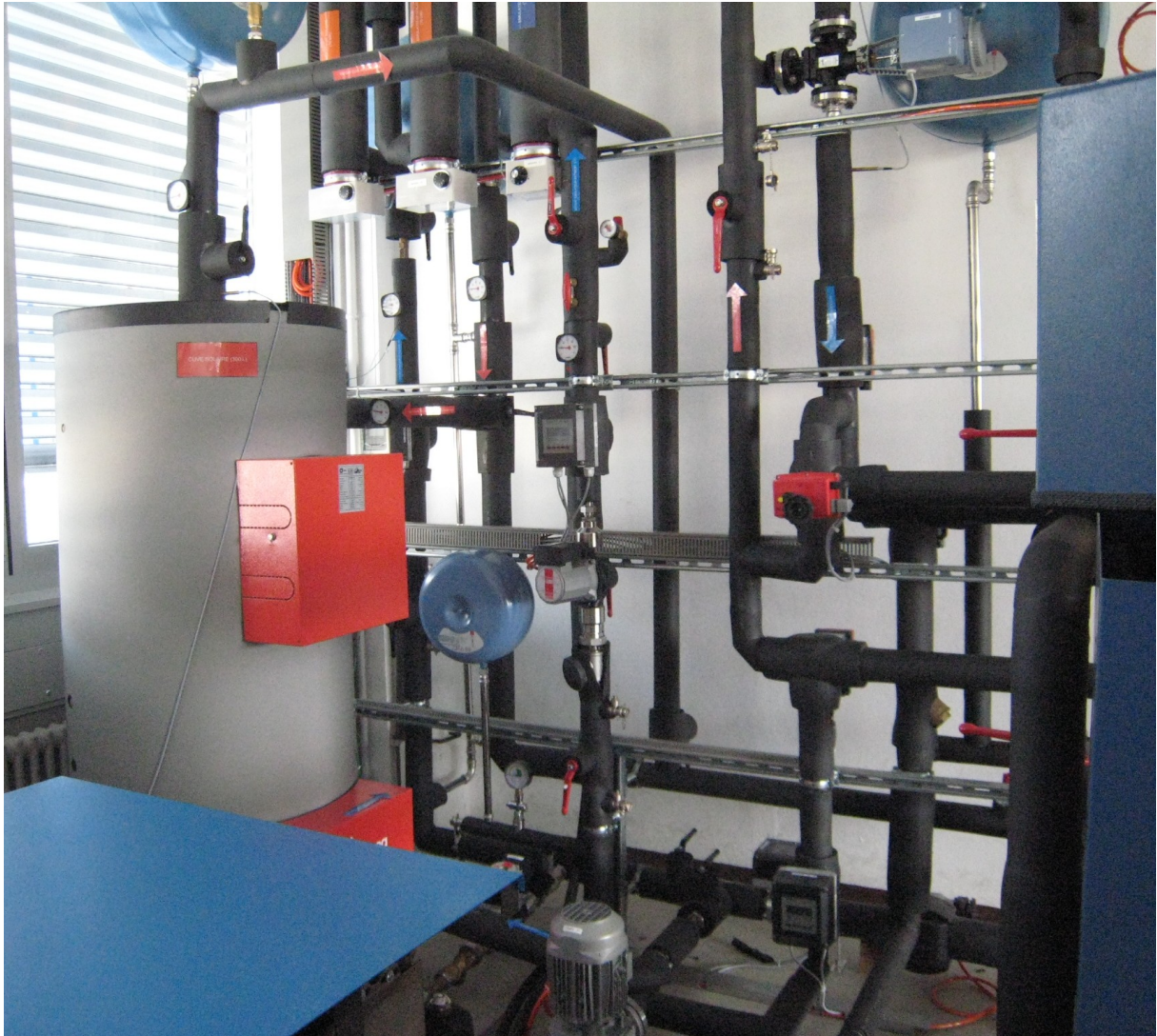
Essais en laboratoire : un système thermohydraulique simule le fonctionnement d'une pompe à chaleur d'adsorption. Source : HEIG-VD
