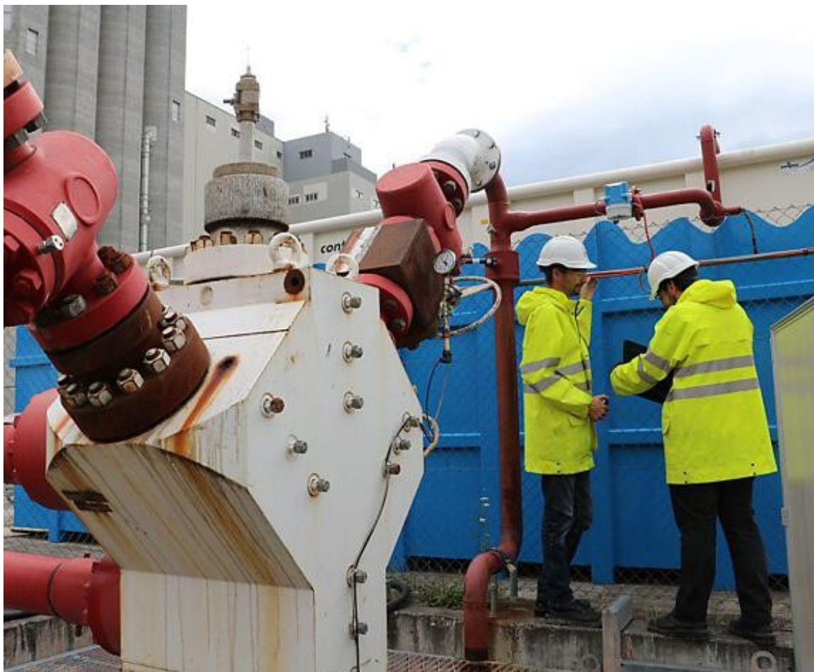
Pour l'instant, le forage reste inutilisé : à Bâle, un projet pilote de production géothermique d'électricité et de chaleur a été interrompu en raison des séismes qu'il a générés. Source : IWB/Erik Rummer
