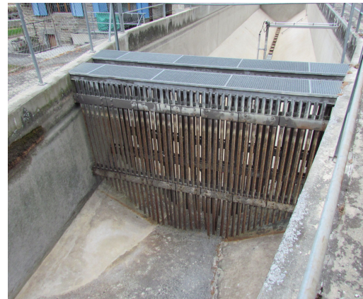
Des râteaux placés dans les bassins calment le courant et contribuent à un dessablage efficace. undefined
