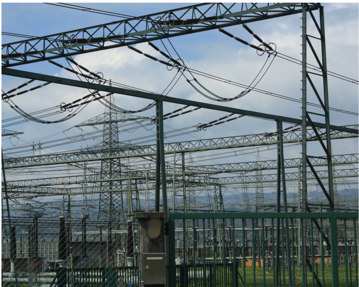
L'« étoile de Laufenburg », berceau suisse du réseau électrique européen. Source : Wikimedia Commons / Badener
