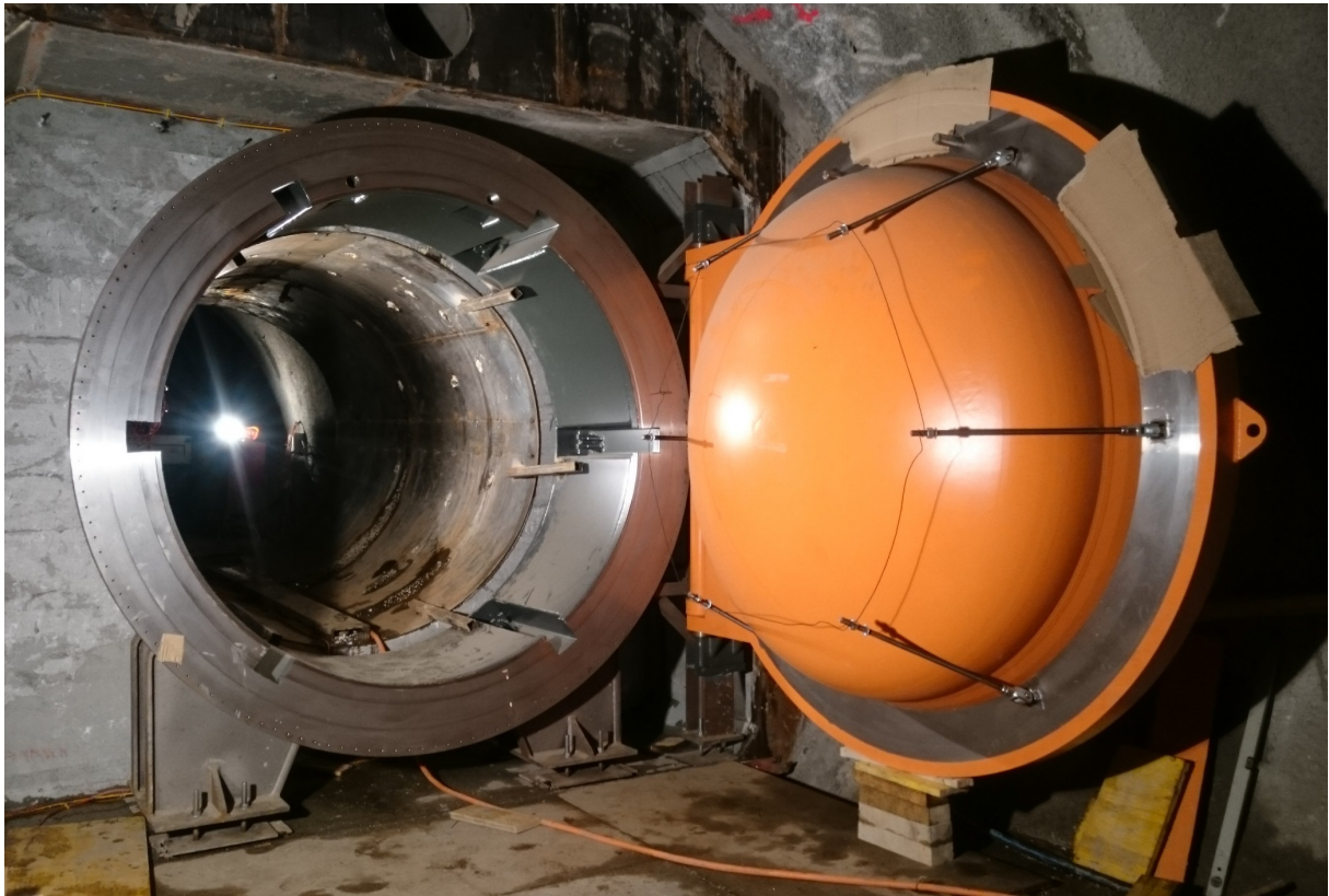
Accumulateur d'air comprimé dans les Alpes : site pilote servant à tester le stockage de l'électricité issue de sources d'énergie renouvelables. Source : ALACAES
