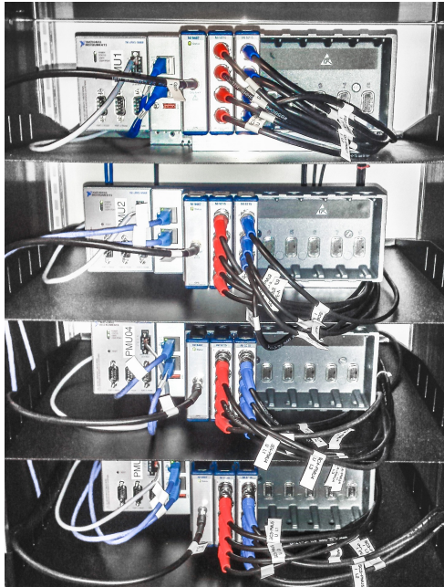
Demonstration der Echtzeitsteuerung von Stromflüssen im realen Micronetz der ETH Lausanne Quelle: Projekt «Echtzeitsteuerung von Stromflüssen»
