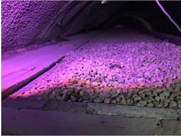
Blick in den sensiblen thermischen Speicher in der Pilotanlage bei Biasca. Der Speicher ist mit Kieselsteinen von einem Durchmesser von rund 2 cm gefüllt. Quelle: Andreas Haselbacher
