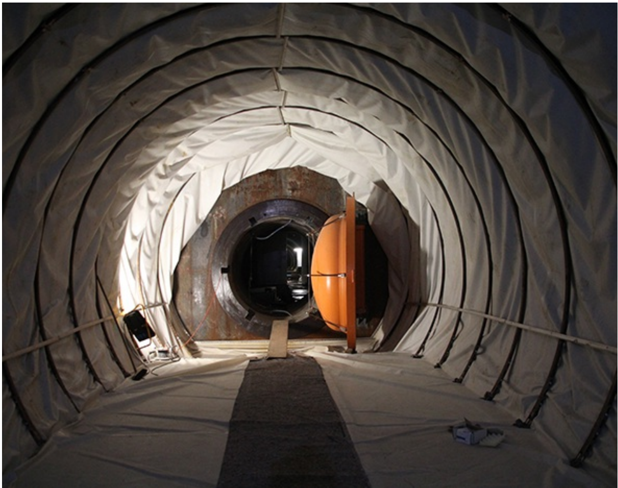
Das Innere eines Druckluftspeichers – hier wird komprimierte Luft im Berg gespeichert. Quelle: ALACAES
