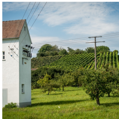
SiC-Festkörpertransformatoren im Stromnetz
