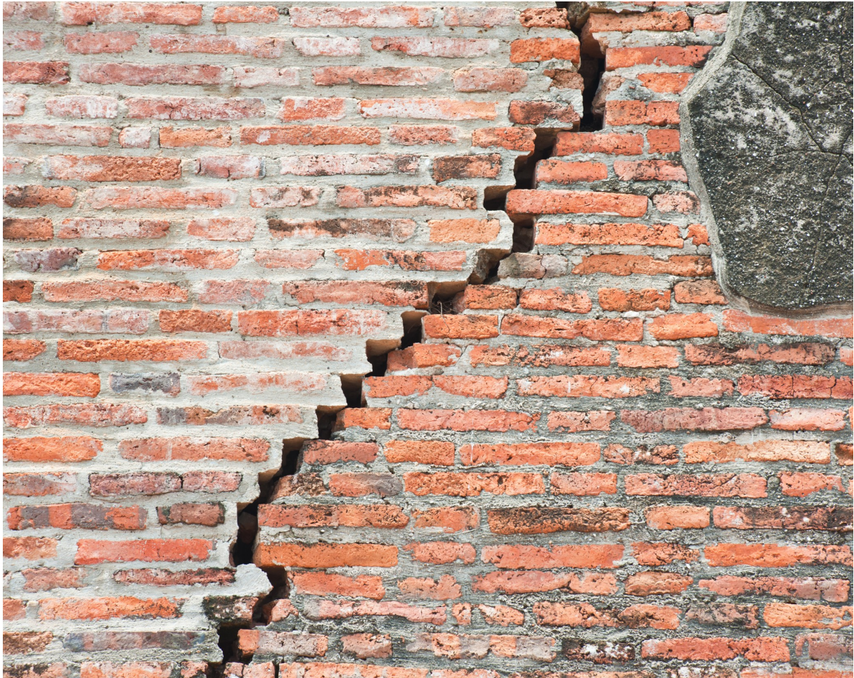
Schäden wie Risse in einer Wand sollten nicht auftreten – auch wenn in der Nähe eine Geothermie-Bohrung durchgeführt wird. Quelle: Shutterstock
