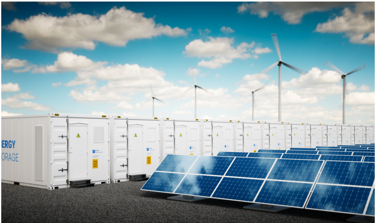
Dezentral erzeugte Energie aus Sonne oder Wind benötigt lokale Speicherkapazitäten in stationären Batterien. Dabei helfen die neu entwickelten Batteriesysteme. Quelle: Adobe Stock
